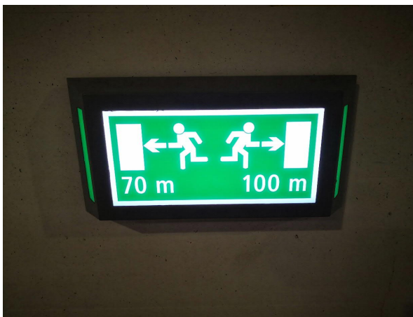
Bild 15: Hinterleuchtetes Notausgangssignal, Februar 2021
